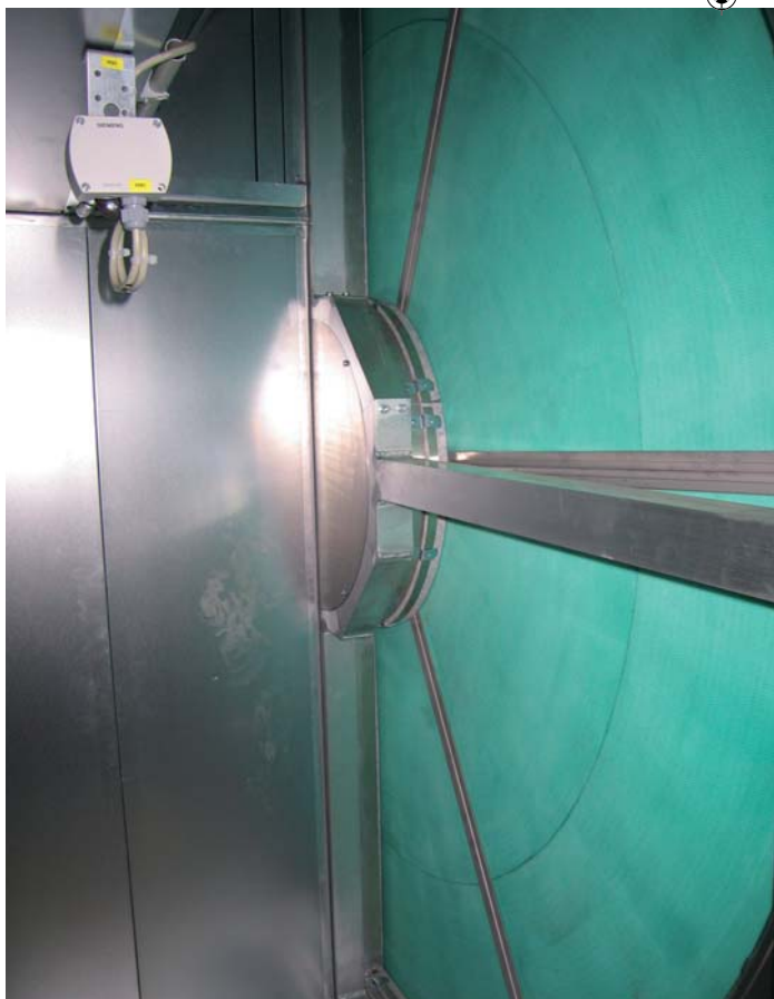
Afb. 1 Het adsorptiewiel van een drooginstallatie
